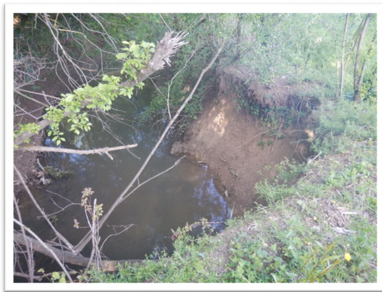
Figure 12 – Exemple d'anse d'érosion sur la Tenise
