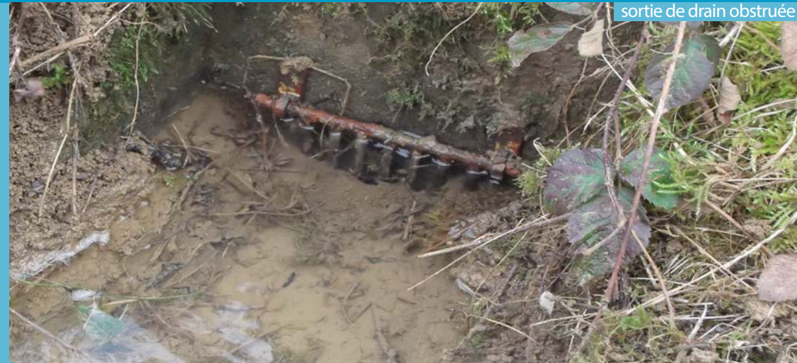
sortie de drain obstruée
